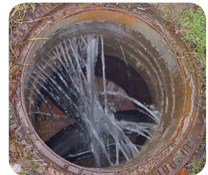
Grundwassereintritt im undichten Kanalschacht.
