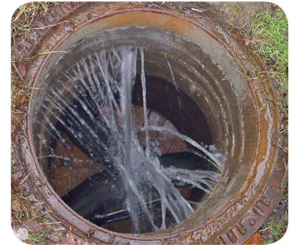
Grundwassereintritt im undichten Kanalschacht.
